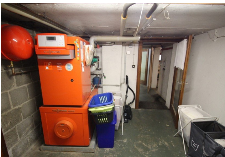
Heizungsraum und Waschküche mit Zugang in den Garten
